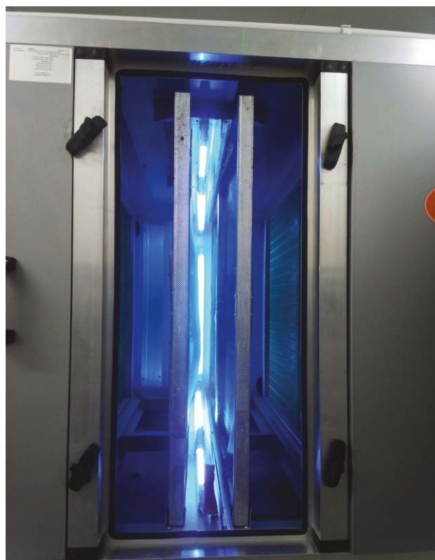
▲ Figura 5 - Porte fotocatalitiche installate all'interno dell'unità di trattamento dell'aria di un impianto di incubazione di pollame nell'aria di mandata.
